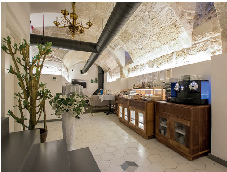
Sistema de climatització capdavantera
